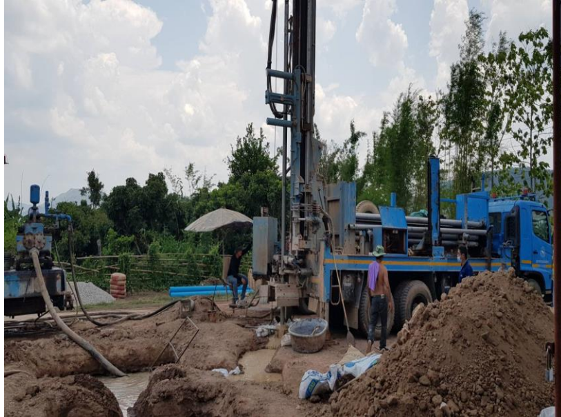
รูปที่ ๖ แสดง การขุดเจาะบ่อน้ำบาดาลโดยน้ำโคลน
